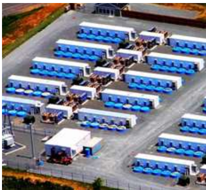
Fig. 11. Sistema de almacenamiento de energía en NY. Fuente: [6]
